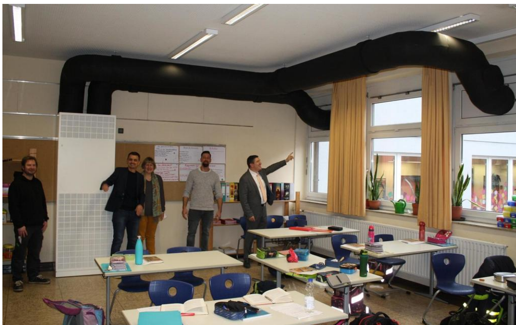
Hausmeister David Häring, Grundschul-Rektor Andreas Ryczko, Mittelschul-Leiterin Andrea Barwig, Tiefbauamtsleiter Nico Friedrich und Bürgermeister Jürgen Spahl unter den beiden mächtigen Lüftungsrohren in einem der Rednitzhembacher Klassenzimmer. (Foto: Gunther Hess)
